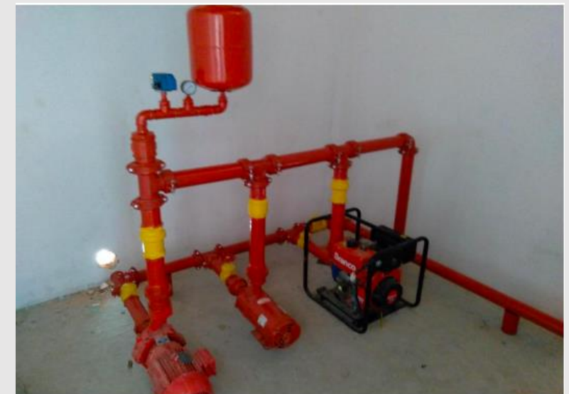
Sistema de bombas da rede de combate a incêndio - Prédio da Reitoria, Barreiras-BA
