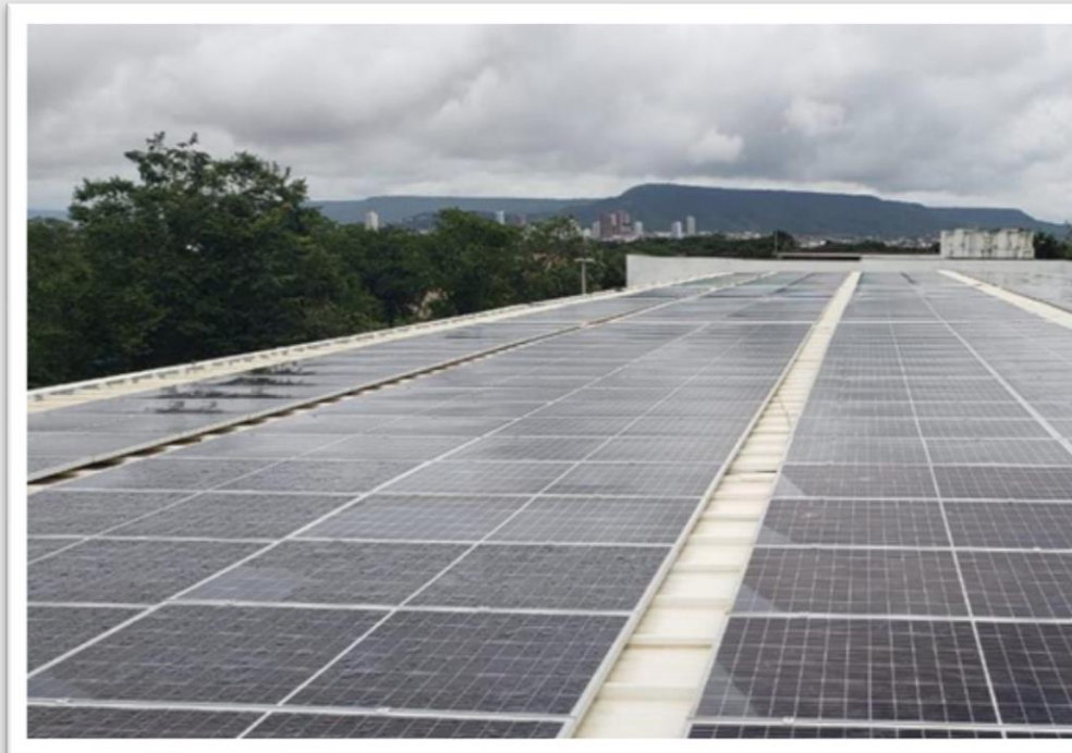
Instalação de sistema de micro geração de energia solar fotovoltaica - campus Barreiras-BA
